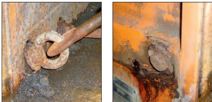
Korrodierte Ringschrauben als „Zurrpunkte“ in der Bordwand
